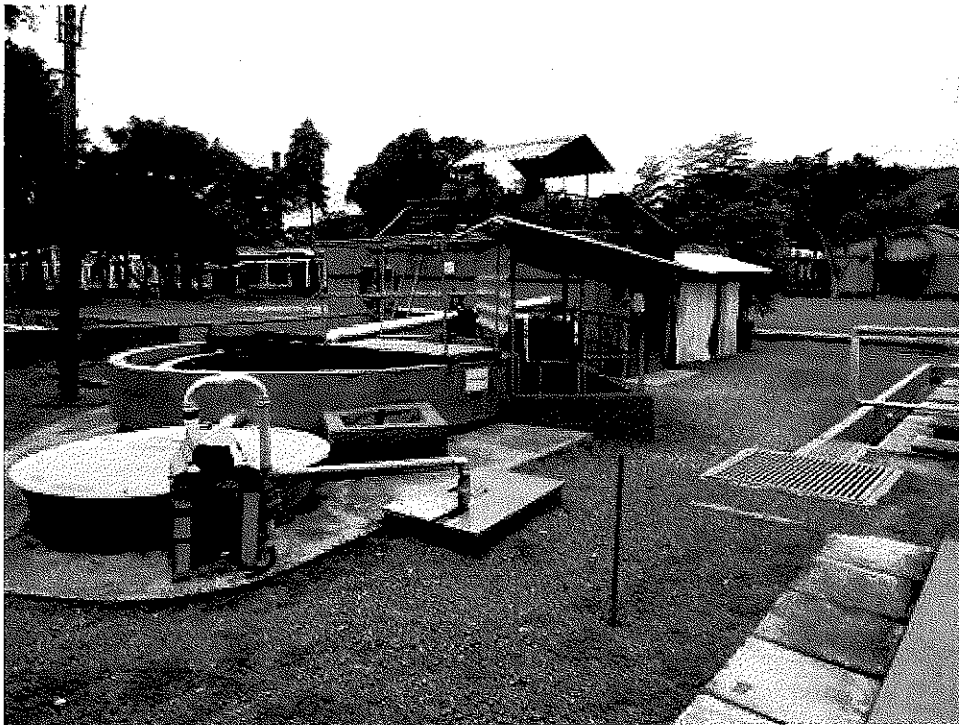
Foto 118: Vista Geral da ETE.
