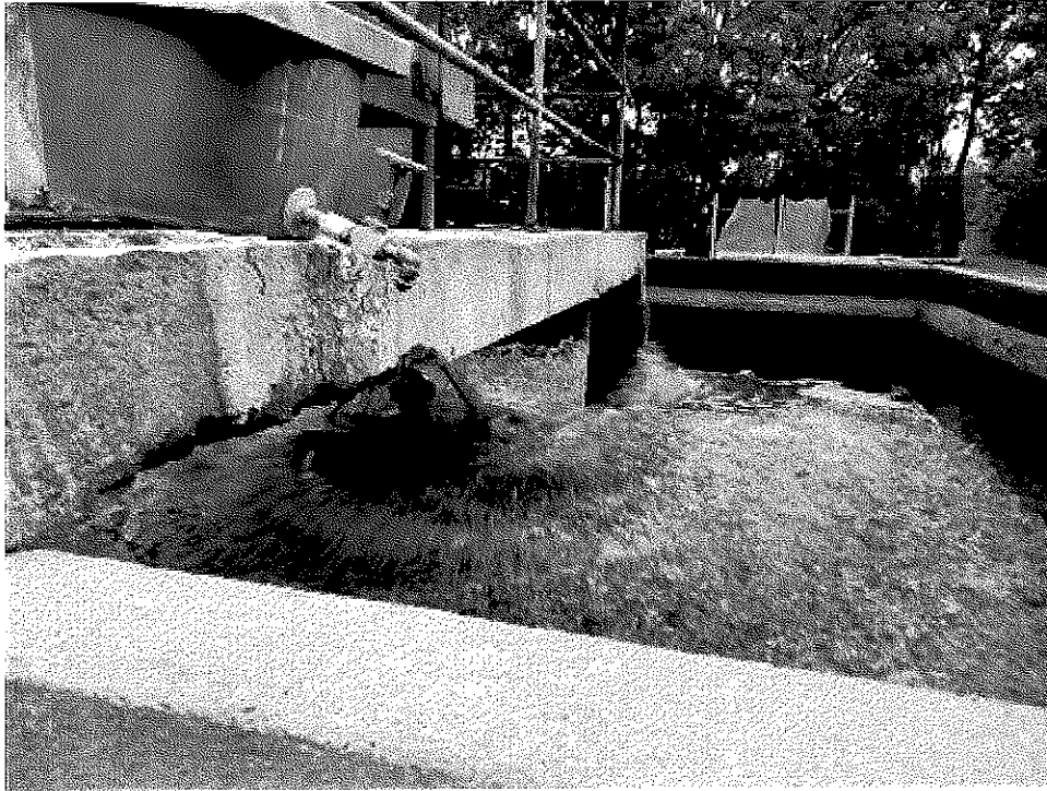
Foto 117: Sistema de Aeradores da ETE.
