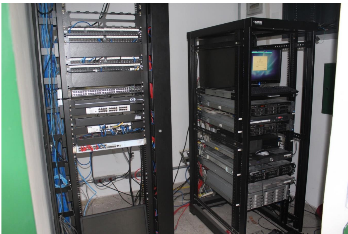
FOTO 104 – SERVIDOR DELL E SWITCHs DE INFORMÁTICA DA EMPRESA.
